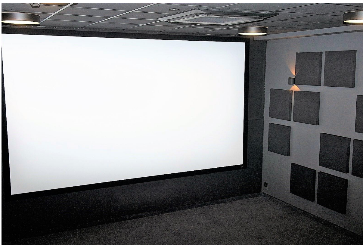
Rys. 16: Ściana akustyczna z ekranem, głośniki przykryte są tkaniną akustyczną.
