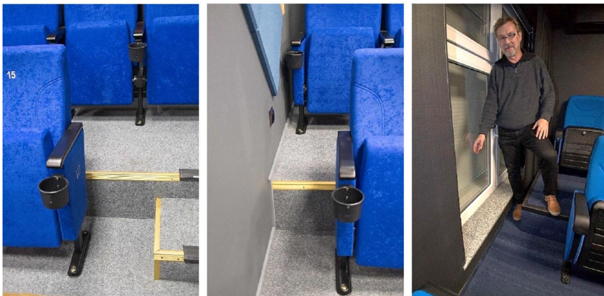
Rys. 52: Przykłady nieprawidłowego zabezpieczenia przejść. Nogi foteli powinny dotykać do krawędzi stopnia. Każda wolna przestrzeń musi być zabezpieczona barierką. Cała wnęka okienna musi być zabezpieczona poziomą barierką biegnącą na krawędzi najwyższego poziomu podestu.
