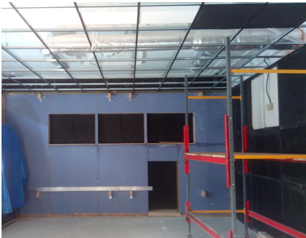
Rys. 7: Na prawej ścianie widoczny drewniany stelaż wypełniony arkuszami wełny mineralnej. Z przodu ściana akustyczna, pod sufitem zawieszono profile dla sufitu podwieszanego.
